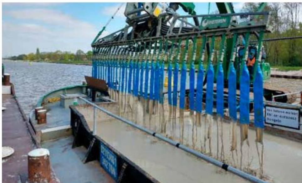
Een door de aannemer ontworpen sproei-installatie waarmee het ZBM vanuit een beun in banen op dichtbij de kanaalbodem wordt aangebracht.
